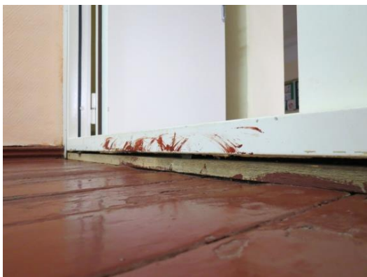
Порог при входе в рекреацию МАУДО « ДШИ №2» с внутренней стороны Отсутствие перекатного пандуса
